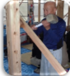
建物の四方を米や塩、酒でお清めした後、棟梁が大きな木槌で骨組みを固め、工事の安全を祈願しました。
